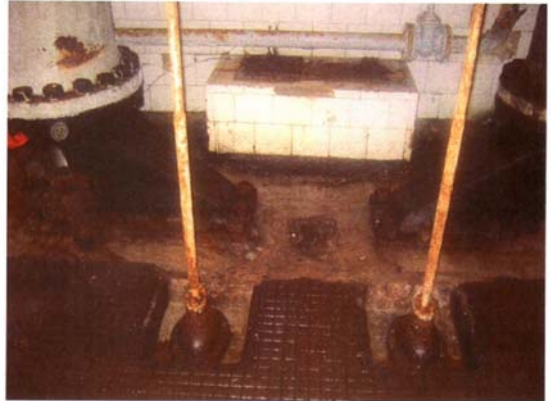
Foto 2.- Falta de mantenimiento de los desagües de fondo
