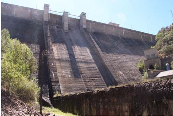
Foto 1.- Mal estado de la superficie del aliviadero
