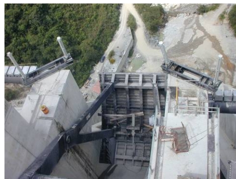
Compuerta después del accidente
