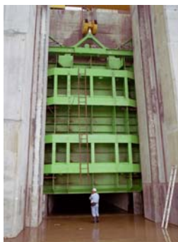
Compuerta de cierre
