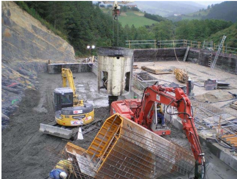
Ilustración 4: Medios de puesta en obra del hormigón. Cazo del blondín, bulldozer de extendido y retroexcavadora con el equipo de vibrado
