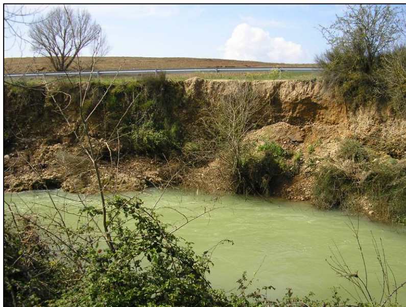
Fig. 8. Erosión avanzada de la margen derecha, junto a la nueva carretera.
