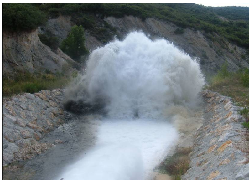
Fig. 4. Funcionamiento incorrecto del cuenco amortiguador.
