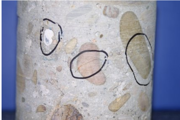
Fig.6: Depósito y áridos fisurados
