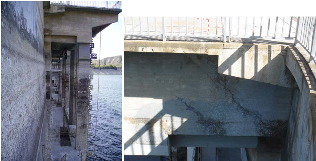
Figura 6.- Fisuración por corte directo en voladizo estructura de compuertas
