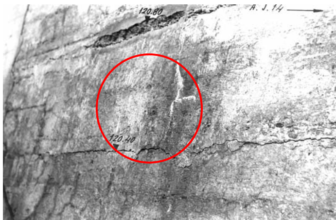
Figura 8.- Fisuración enramada en paramento de aguas arriba, en zona de cota 121.
