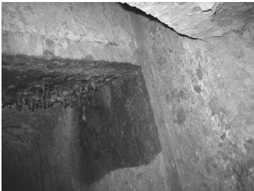
foto 6: Interior de compuertas sin obturador antes del granallado.
