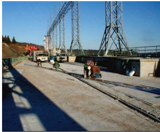
Figura 8. Preparación de las juntas estancas para su instalación (Estación Generadora Mactaquac, Keswick Ridge, Canadá)
