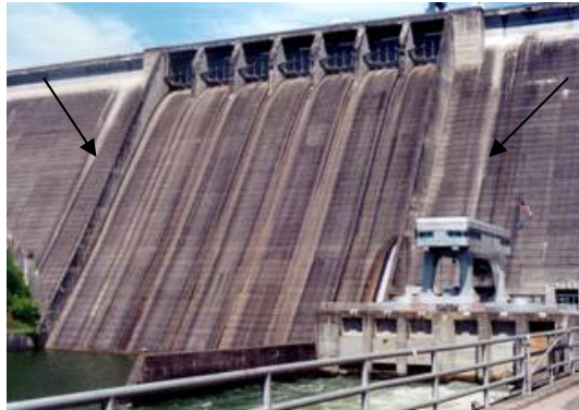
Figura 3. Vista de las dos ranuras cortadas a ambos lados del aliviadero principal de la presa Hiwassee, Tennessee, USA
