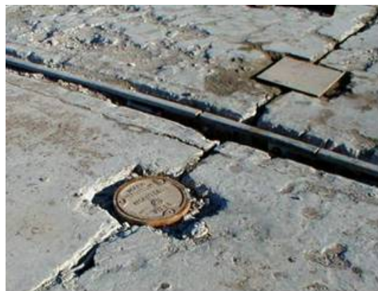
Figura 9. Vista de la tapa metálica de la primera junta estanca ya instalada y de la tapa de madera colocada sobre la perforación para instalar la segunda (Estación Generadora Mactaquac, Keswick Ridge, Canadá)
