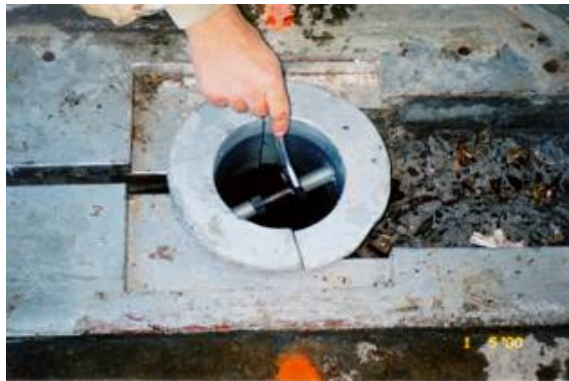
Figura 7. Detalle del anillo superior de fijación de la junta estanca mientras está siendo ajustado (Véase la ranura cortada en el hormigón y el aspecto de éste, en la presa Chickamauga, Tennessee, USA)
