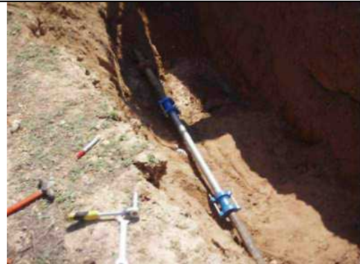
Reparación fuga de agua en tubería de abastecimiento del poblado del embalse de Alfonso XIII
