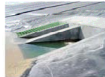
Fotografía 1. Cámara con galería visitable.
