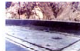
Fotografía 26. Dispositivo flotante de agua potable de Bogotá (Colombia) con una cubierta flotante.
