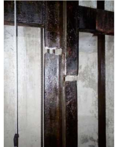
Rotura guía ascensor (solucionado)
