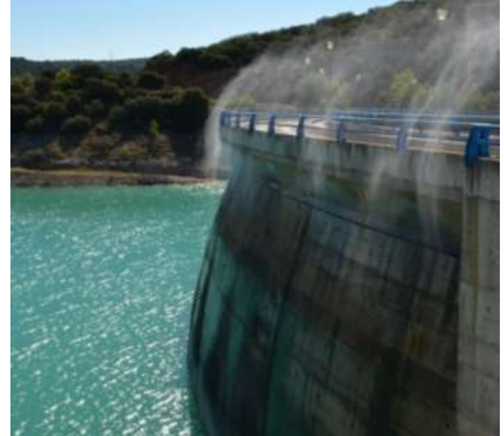
Aspersores en paramentos
