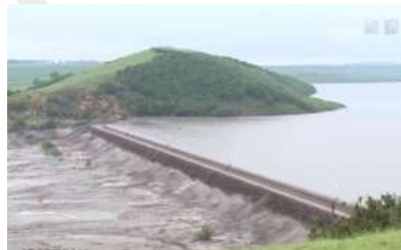
Presa de Xinfu (China) fallo por rebose (Julio 2021)
