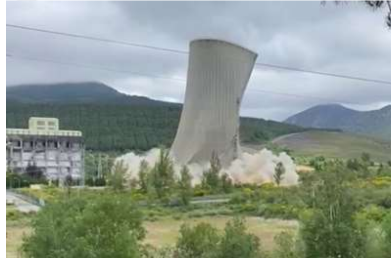
Central térmica de Anllares 2021
