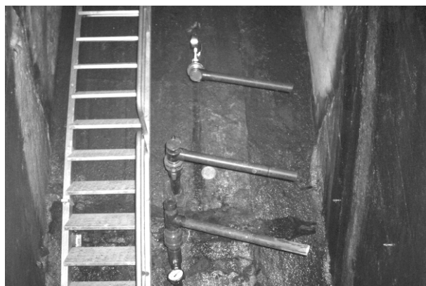
Fig. 9: Dispositivos de aforo de PVC en M.D. de la galería perimetral
