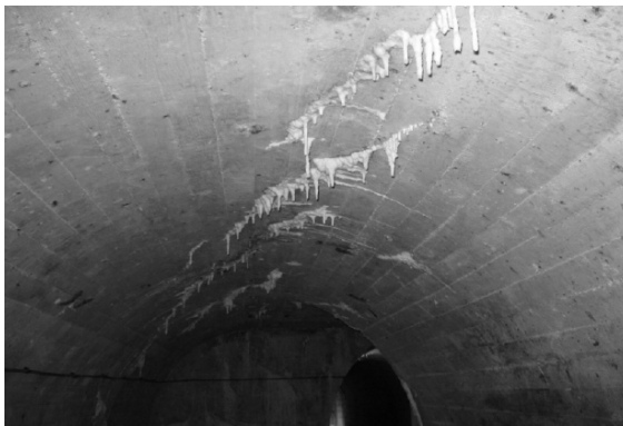
Figura 5- Fisuración oblicua en la galería cota 1350 m cerca de la junta 11
