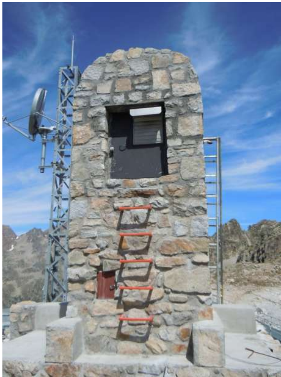
Torre de acceso al recinto de equipos, antena parabólica y pararrayos
