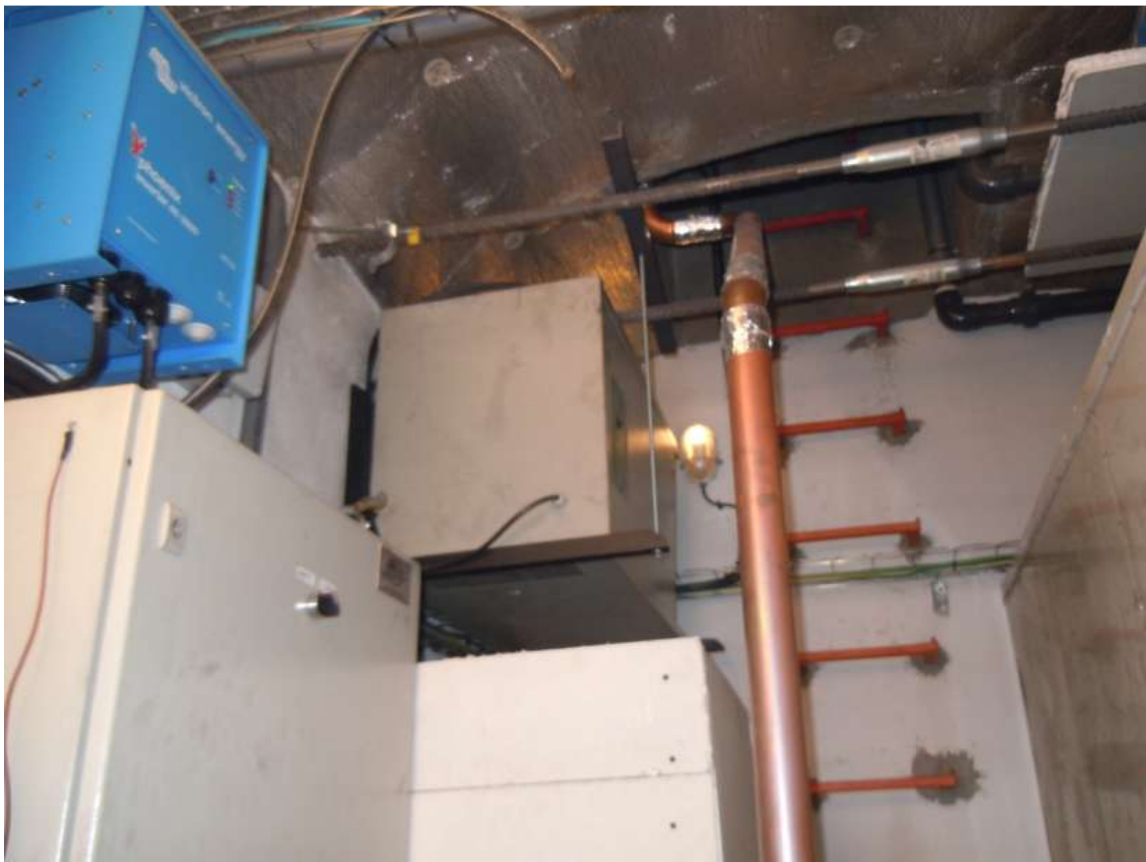
Interior del recinto de equipos de Brazato
