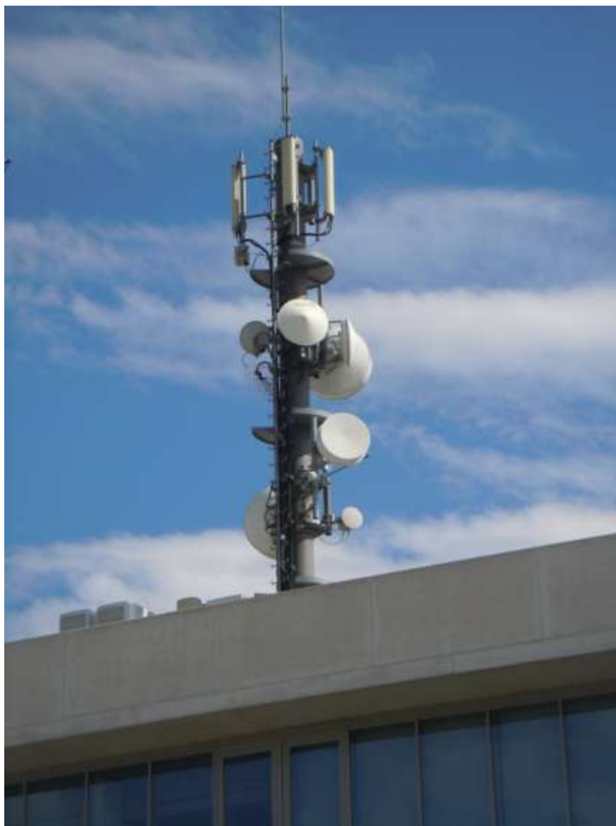
Antena de comunicaciones del edificio de Acciona Energía en Sarriguren (Navarra)
