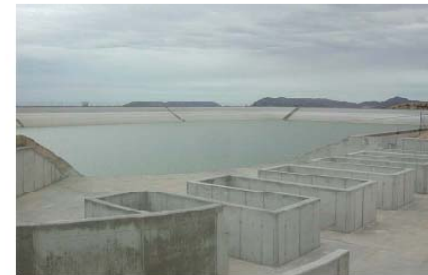
Fotografía 12 Aliviadero en laberinto
