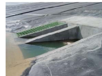
Fotografía 5. Conexión con galería visitable
