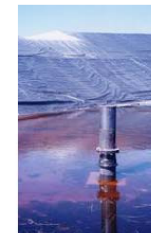
Fotografía 19 Desagüe de fondo. Acople desmontable para limpieza de la balsa. Balsa de Hoyos del Espino (Ávila)
