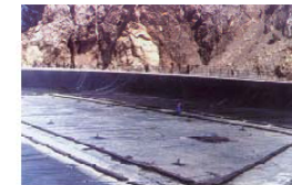
Fotografía 26 Depósito regulador de agua potable de Iznájar (Córdoba) con una cubierta flotante transitable
