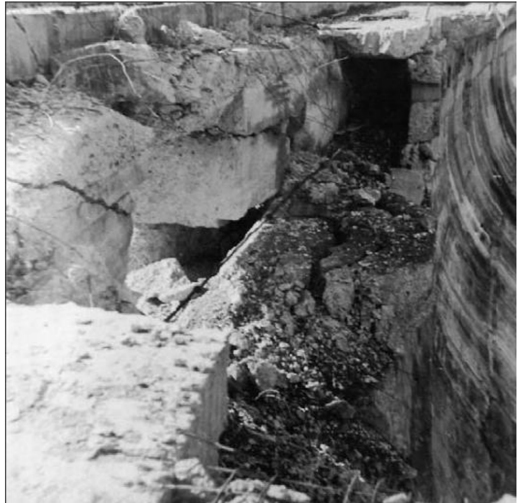
Daños en la presa por la explosión de la dinamita
